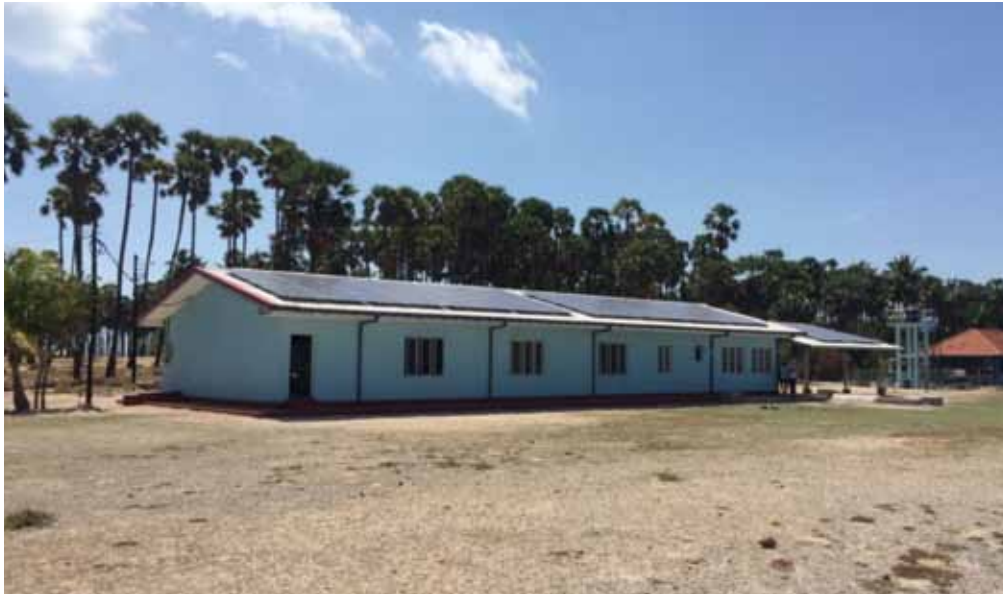
Solar Array on Eluvaithivu Island.
